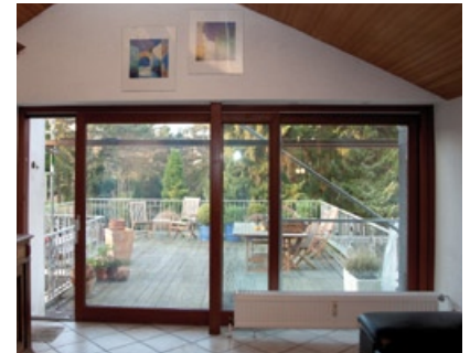
Die Terrassentür stammt aus dem Jahr 1982, die beiden Holzrahmen sind in gutem Zustand. Hier bietet sich der Einsatz von Sicherheitsglas an.
