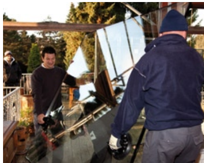
Die Vakuumsauger kommen wieder zum Einsatz: Mit vereinten Kräften wird die neue Scheibe vorsichtig in den Rahmen eingesetzt.
